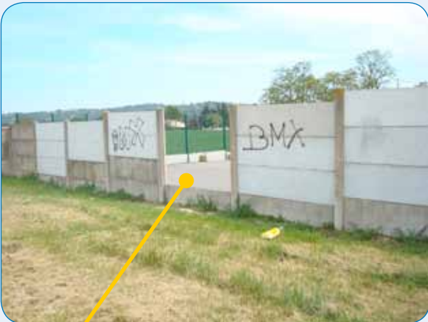
CLOISONS ARRACHÉES ET TAGUÉES
