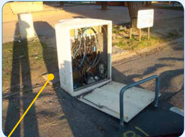
ARMOIRE ÉLECTRIQUE CASSÉE
